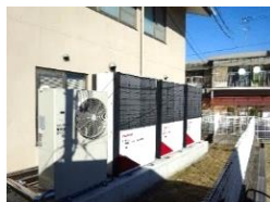
新しくなった室外機
